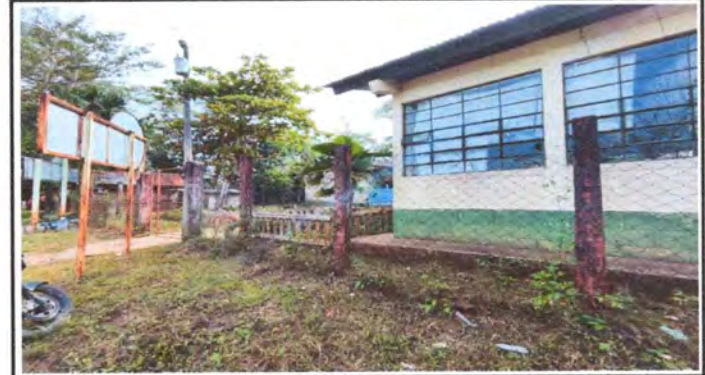
Foto 4: Se observa la continuacion de la circulacion del predio deteriorado
